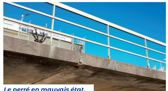
Le perré en mauvais état.
